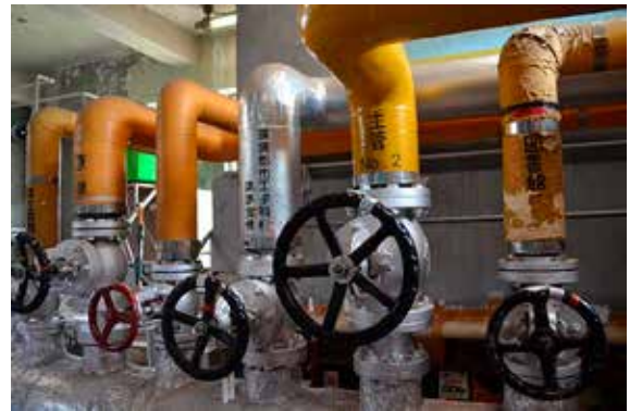
写真 4 スチーム配管(ボイラー室内)
