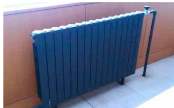
写真 2 スチーム暖房機(ラジエーター)
