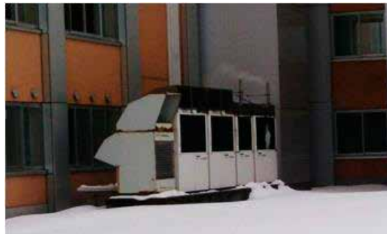
写真 1 ガスヒートポンプ室外機
